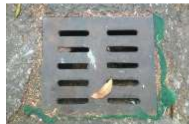
圖 6 十孔水溝蓋阻塞
