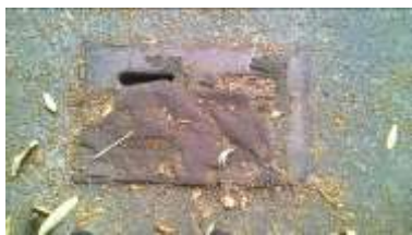
圖 1 水溝蓋紗網破損
