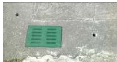
圖 3 R.C 水溝蓋旁圓孔 未設置紗網
