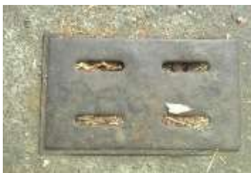
圖 4 四孔水溝蓋紗網阻塞
