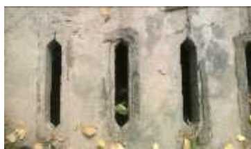
圖 2 R.C 水溝蓋紗網脫落
